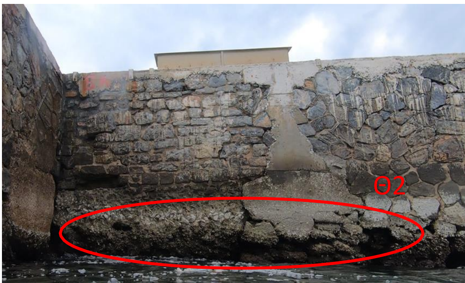
Εικόνα 2.7 Έξαλες εσοχές [Θέση: Θ2]
