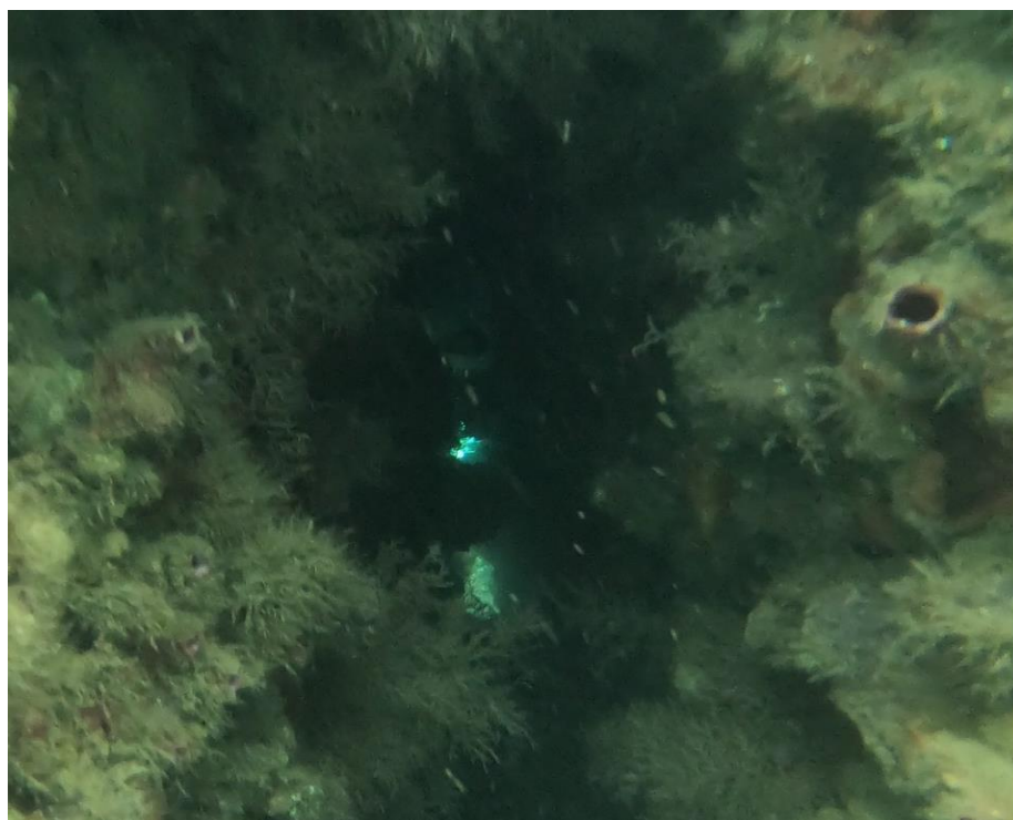
Εικόνα 2.20 Διαμπερές άνοιγμα στην υπήνεμη πλευρά [Θέση: Θ14]
