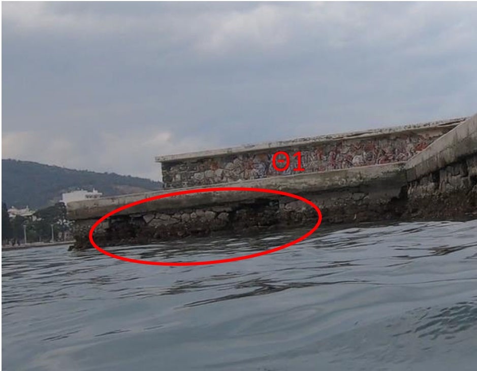
Εικόνα 2.6 Έξαλες εσοχές [Θέση:Θ1]
