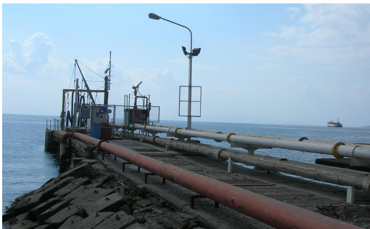
Φωτ. ΙΙ.Ε.3: Αγωγοί Εφοδιασμού από Δ/Ξ
